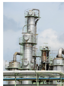
Tuberías de la refinería de petróleo:
