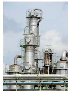
Tuberías de la refinería de petróleo:
